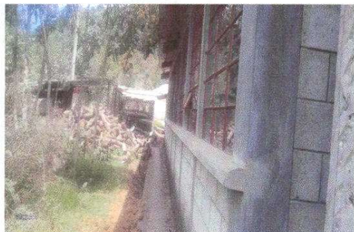
Foto 1: En la foto se observa que es necesario repellar y cernir
