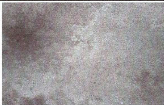
Foto 3: En esta foto se visualiza como la torta de cemento del piso ya está deteriorada por el pasar de los años
