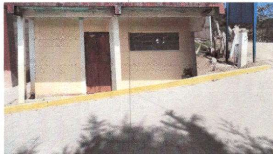
Foto 2: En esta fotografia se evidencia como la ventana ya está en mal estado, con algunos vidrios quebrados
